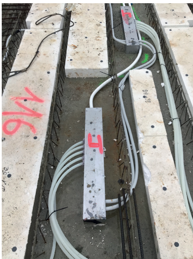
Detailbild vom Heizverteiler Nr. 4 auf der Platte Nr. 116 mit den angeschlossenen Leitungen der einzelne Heizkreise
