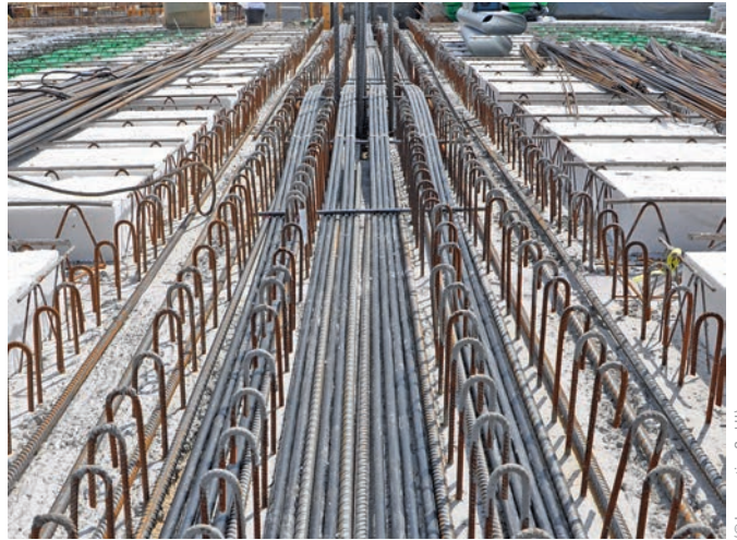
Bild 13 Spannkabel in Bündel zusammengefasst, innerhalb eines Gurtstreifens verlegt Prestressed cable grouped in bundles laid within a column
