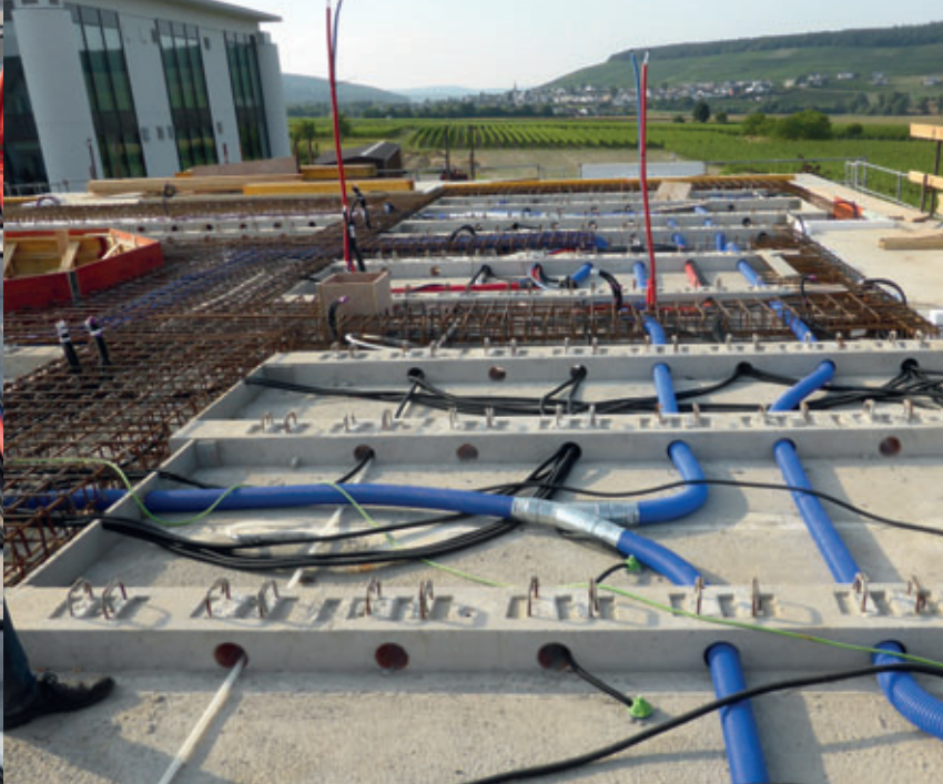
Die kompletten Haustechnikkomponenten im Deckenhohlraum
