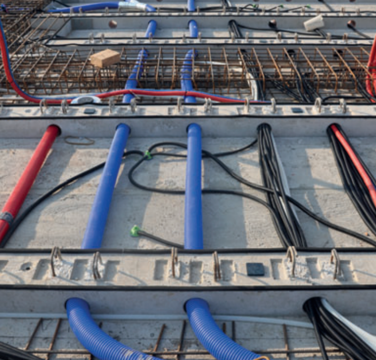
Versorgungsleitungen verlaufen geordnet durch die Öffnungen der Rippen
