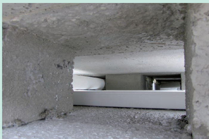
Das Sandwich-Element bietet im 20 Zentimeter großen Hohlraum ausreichend Platz für eine geordnete Leitungsführung.
